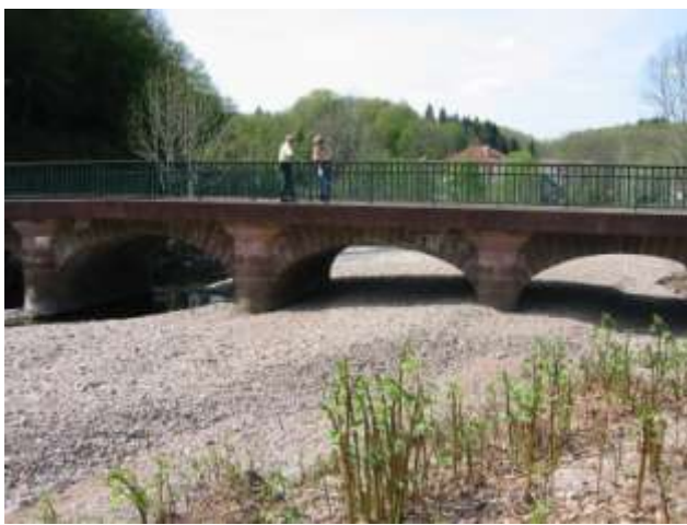
Secteur de Belonchamp : forte accumulation alluviale sous et de part et d'autre du pont de Fresse. Un déblaiement semble nécessaire.
