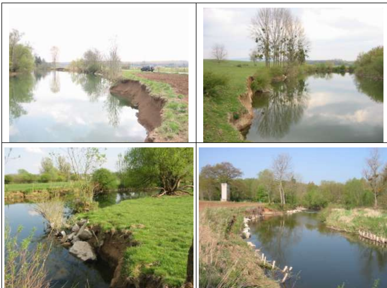
planche photo 11 : zones d'érosion latérale entre les protections existantes
