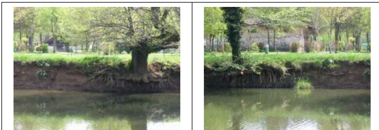
planche photo 13 : amont du barrage de Bonnal, fortement dégradé
